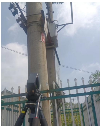
变电站状态监测
